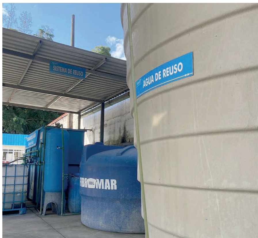
Sistema de Reuso de Água de uma Garagem de Ônibus
