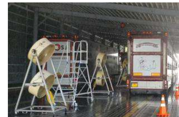
送風機による換気
