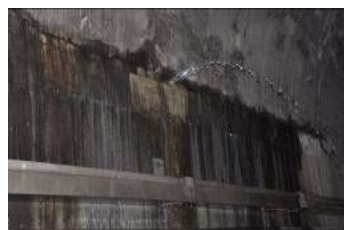
多良一號隧道施工縫漏水
