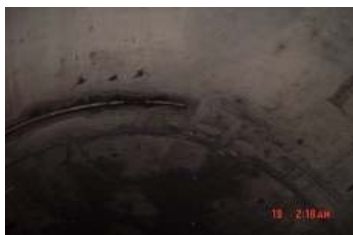
安朔隧道頂拱漏水
