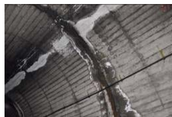
枋山五號隧道側壁裂縫滲水
