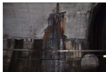
中央隧道側壁滲水
