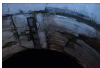
菩安隧道頂拱裂縫
