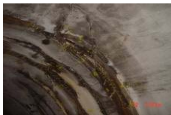
安朔隧道側壁裂縫滲水
