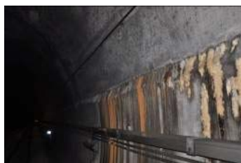
中央隧道起拱線滲水
