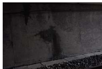
新吉隧道內滲水
