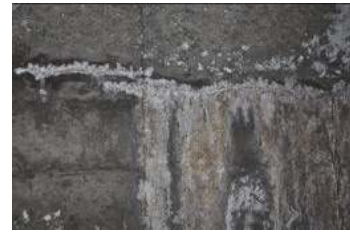
加津林隧道側壁裂縫
