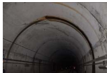
古莊一號隧道頂拱導水
