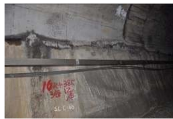
枋山三號隧道起拱線裂縫
