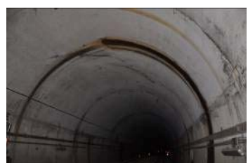
古莊三號隧道頂拱導水
