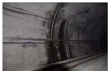
古莊一號隧道側壁裂縫滲水
