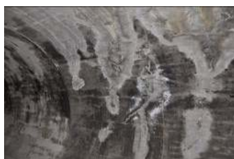
枋電二號隧道側壁白華
