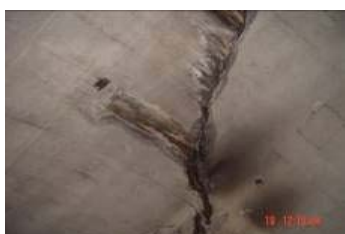
中央隧道頂拱裂縫
