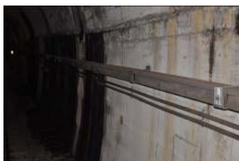
枋野三號隧道起拱線滲水
