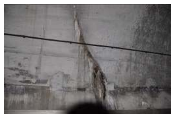
古莊二號隧道側壁裂縫
