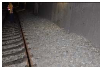
枋山四號隧道排水溝堵塞
