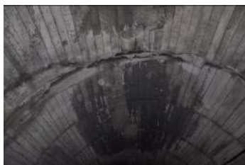
大竹二號隧道頂拱裂縫
