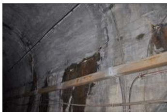
瀧溪隧道側壁滲水
