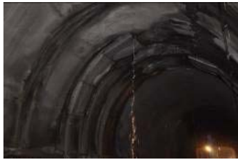
大鳥隧道頂拱漏水
