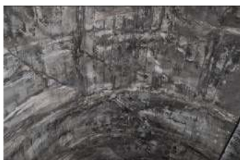
大竹四號隧道頂拱裂縫
