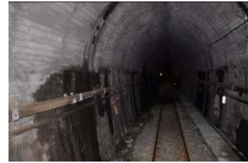
大竹二號隧道側壁滲水
