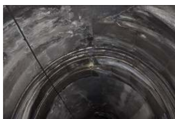
多良 2-1 號隧道頂拱漏水
