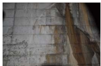
古莊七號隧道側壁滲水
