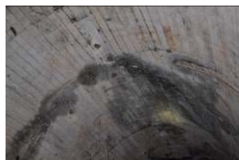
多良二號隧道頂拱裂縫
