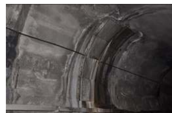
多良 2-1 號隧道側壁導水
