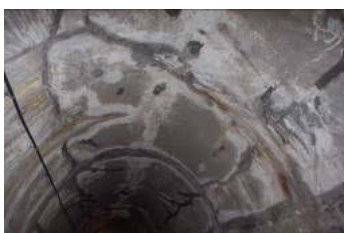
枋野二號隧道頂拱裂縫
