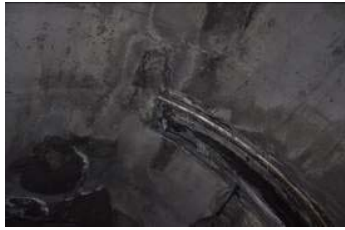
大竹一號隧道頂拱導水
