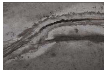
枋山二號隧道頂拱裂縫
