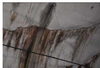
古莊二號隧道頂拱漏水
