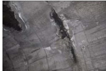
大竹一號隧道側壁滲水
