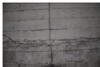
古莊七號隧道側壁裂縫
