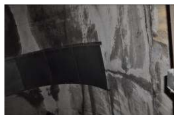
古莊五號隧道頂拱導水
