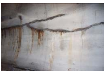
枋野一號隧道側壁裂隙
