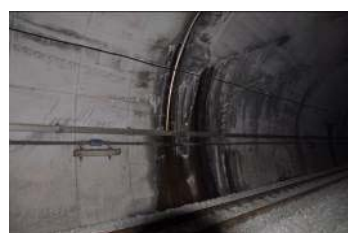
古莊三號隧道側壁裂縫滲水
