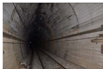
古莊六號隧道側壁裂縫
