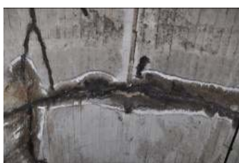
枋山五號隧道頂拱裂縫滲水
