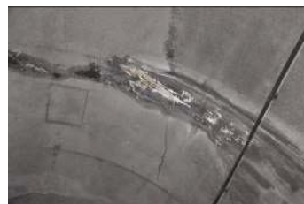
大鳥隧道頂拱裂縫
