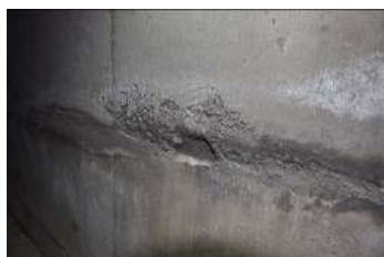
香蘭隧道內混凝土剝落
