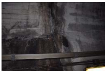
枋山二號隧道起拱線滲水
