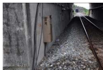
枋電一號隧道排水溝阻塞
