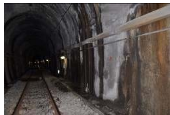
大竹三號隧道側壁滲水
