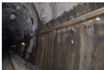
枋山一號隧道起拱線滲水
