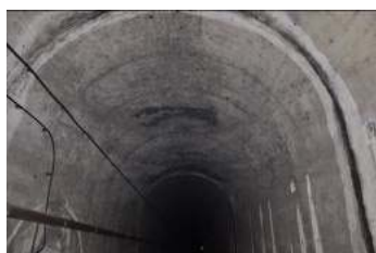
嘉和遮體施工縫裂隙
