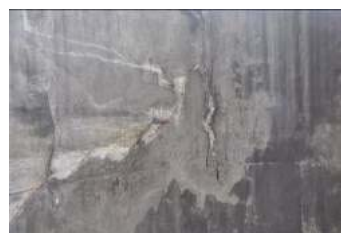
枋電二號隧道側壁裂縫
