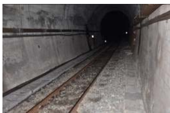
多良二號隧道側壁裂縫
