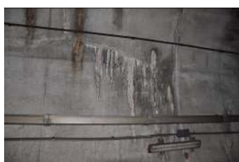
新吉隧道內裂縫
