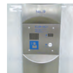
非常用インターホン
