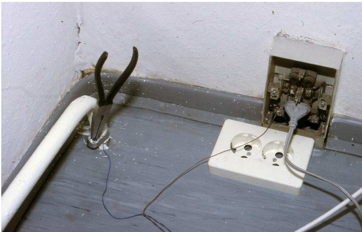
In der obersten Etage im operativen Stützpunkt wird der Empfänger zwischen Nullleiter und Heizungsrohr angeschlossen.
