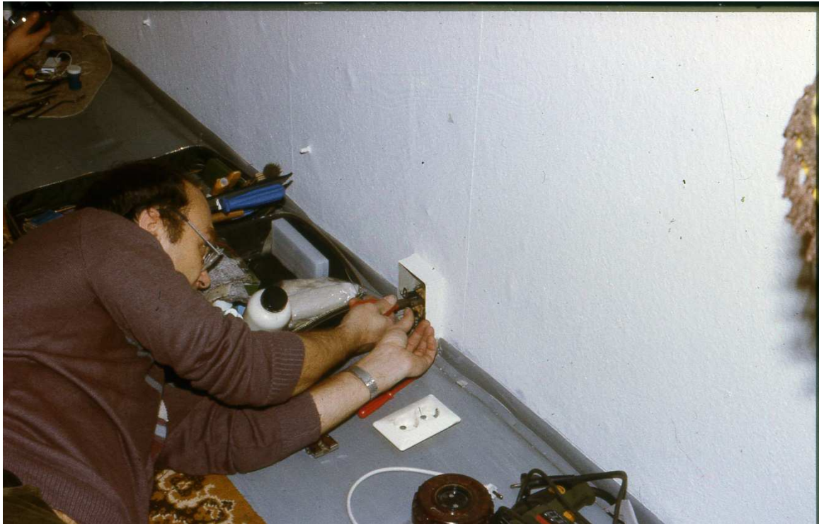
Der TF-B-Sender wird an den Nullleiter in der Steckdose angeschlossen und an das Heizungsrohr
