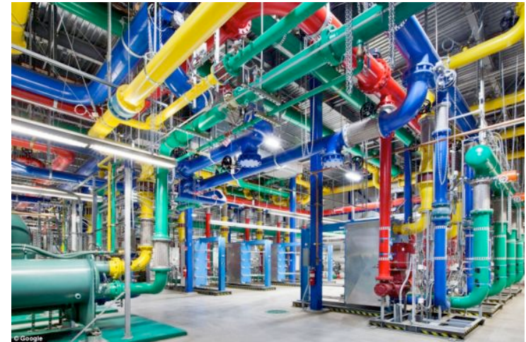
データセンター内のカラフルな配管
